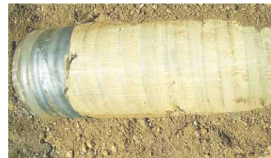
BB protect ® après la mise à la terre
